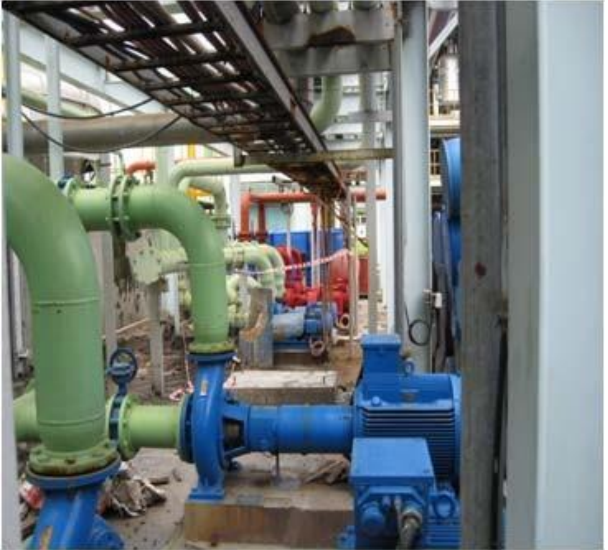
HỆ THỐNG BƠM VÀ TỦ ĐIỀU KHIỂN PUMP SYSTEMS, PIPES AND CONTROL PANEL
