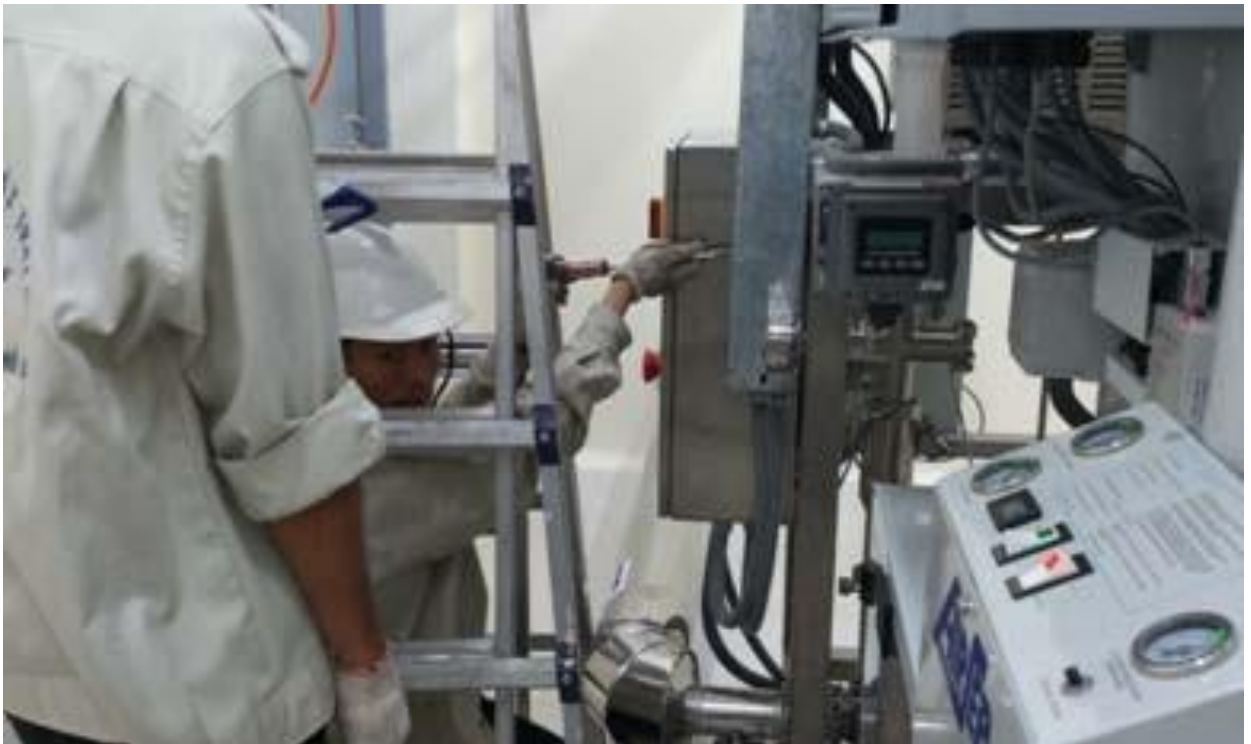
LẮP ĐẶT ĐIỀU KHIỂN VÀ ĐỘNG LỰC HỆ THỐNG OZONESKID CONTROL & POWER FOR OZONESKID SYSTEM
