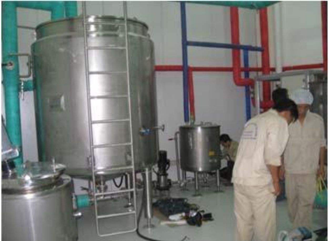
HỆ THỐNG BỒN KHOÁY, ĐƯỜNG ỐNG VÀ TỦ ĐIỀU KHIỂN TANK SYSTEMS, PIPES AND CONTROL PANEL
