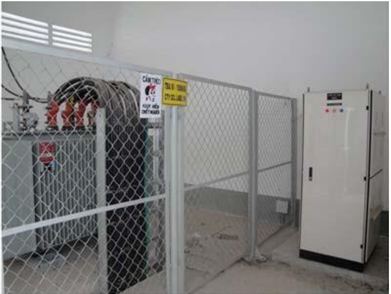
HẠ TRẠM VÀ TỬ PHÂN PHỐI 1250KVA POWER STATION 1250KVA
